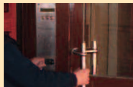
Mise en place d'un contrôle d'accès par carte "La Verrerie"
